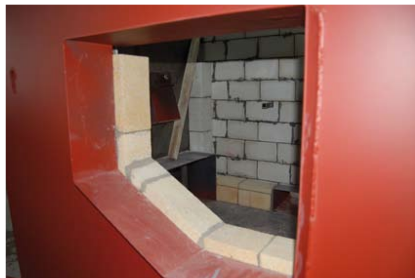
Jakość wykonania wykładzin ceramicznych palenisk decyduje o trwałości całego kotła.
